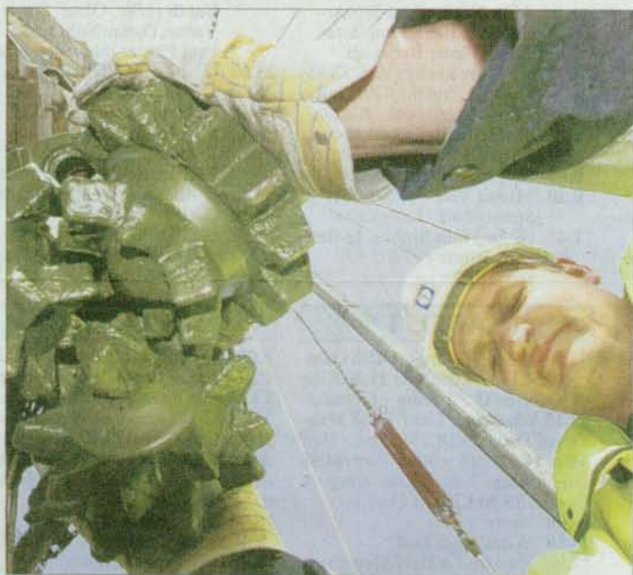
Ein Techniker richtet über dem Bohrloch für einen unterirdischen \text{CO}_2 -Testspeicher den Bohrkopf ein. Die Bundesregierung will die unterirdische Speicherung von Kohlendioxid vorantreiben. Foto: dpa
